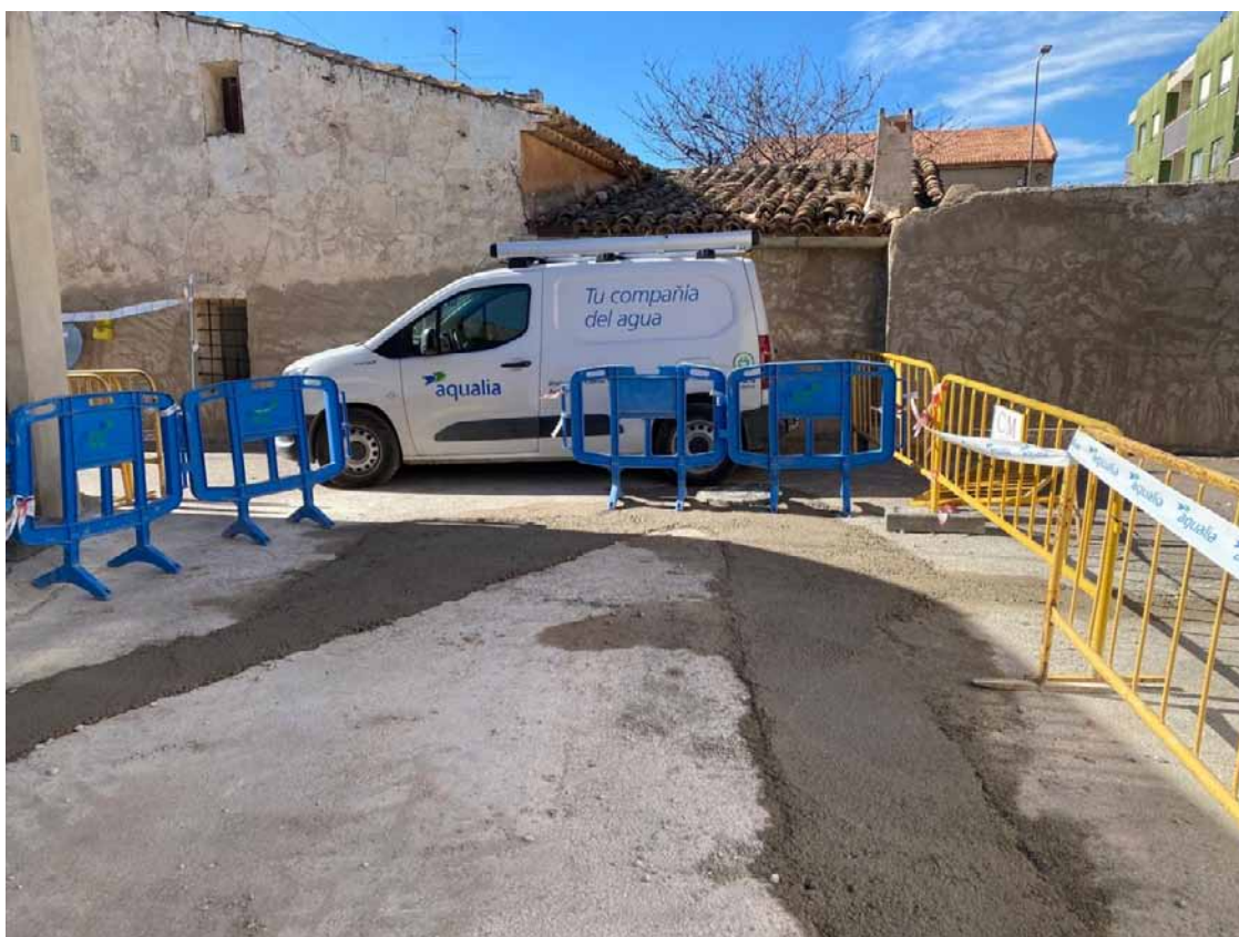
Alcantarillado de Aqualia en Hondón de los Frailes
